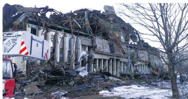
Рис. 2. Поврежденные стальные конструкции здания после продолжительного пожара
