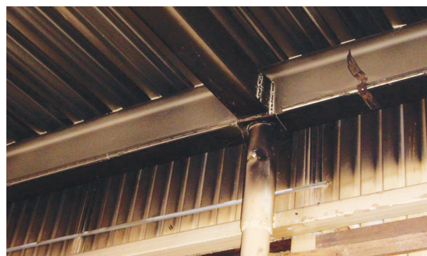
Рис. 1. Поврежденные стальные конструкции здания после непродолжительного пожара
